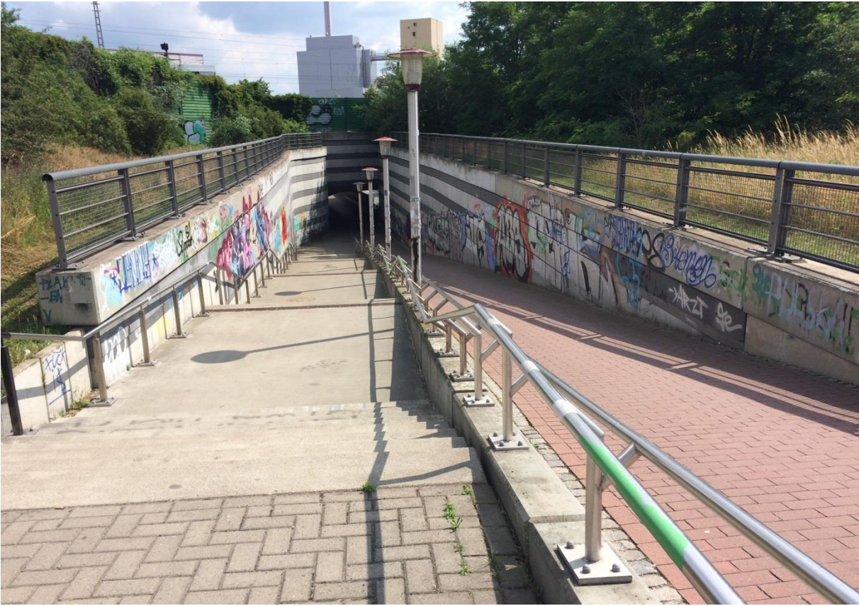
Fuß- und Radweg Hemelinger Tunnel / Übergangsbereich zum Tamra-Hemelingen-Park (Stadtteil Hemelingen, Ortsteil Hemelingen)
